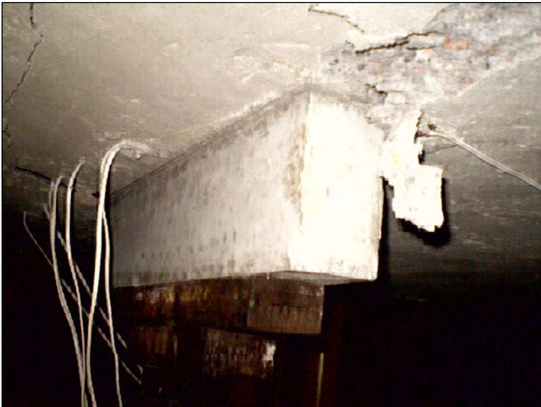
Figura 4.33 – Observação do esmagamento do concreto da laje L4A
