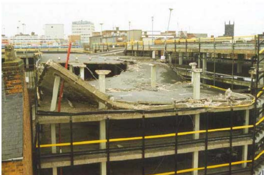
Figure 1.2 – Colapso parcial da laje do quarto andar de um estacionamento em Wolverhampton, Inglaterra (Wood, 1997)
