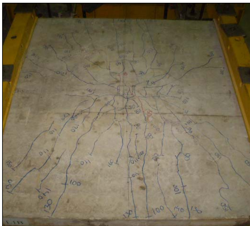
Figura 4.60 – Mapa de fissuração da laje L1B
