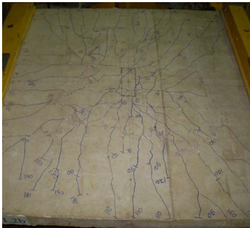
Figura 4.62 – Mapa de fissuração da laje L2B
